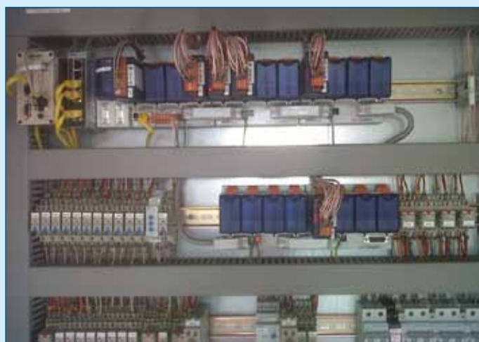
Figuur 2. Besturingskast binnen het gebied Kaag en Braassem voorzien van PLC's van Saia Burgess Controls met communicatie via webserver.
