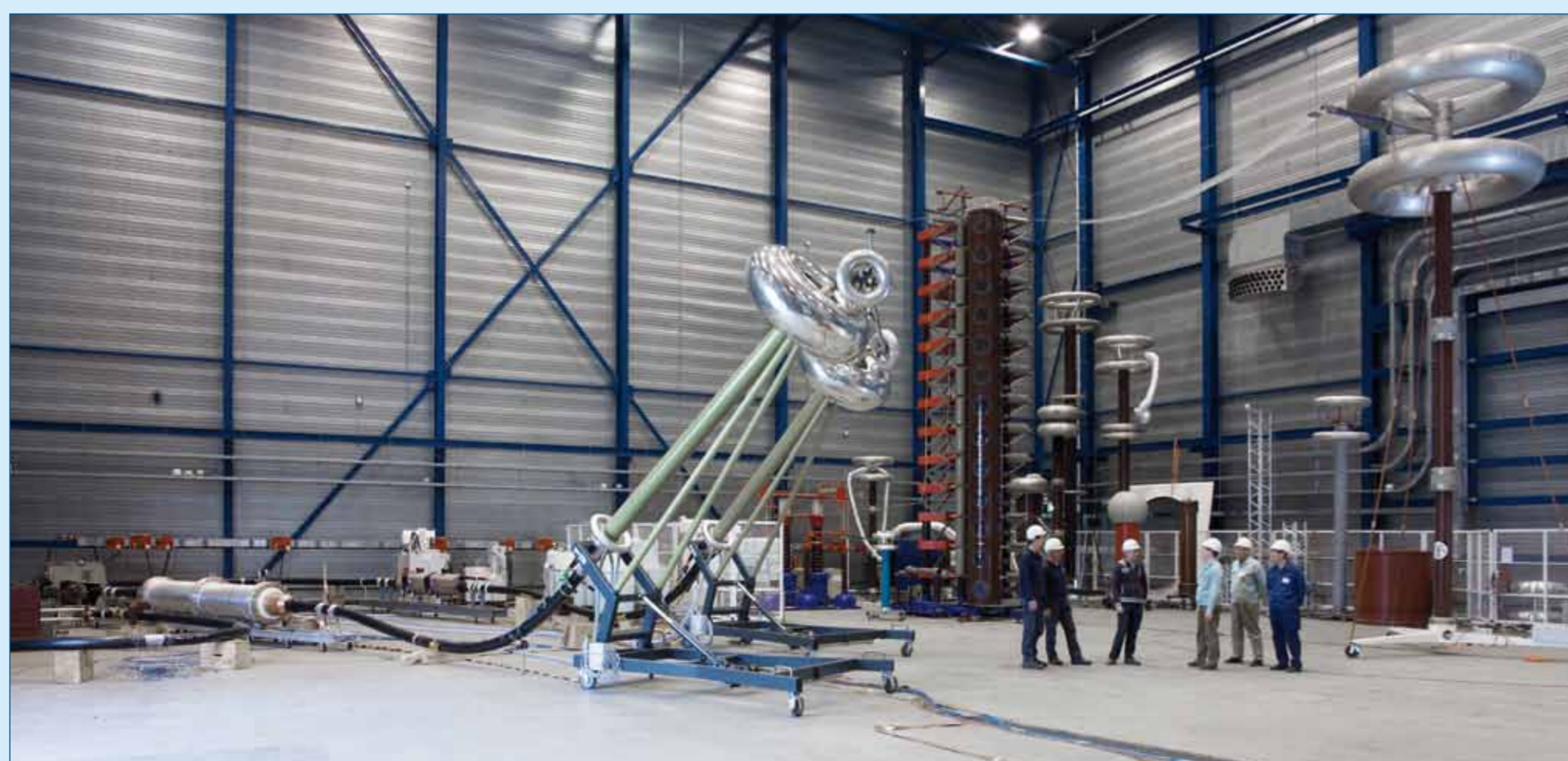
Afbeelding 1. Testopstelling 400 KV kabelsysteem met stootspanningsgenerator 2,6 MV en 3000 kV divider rechts. Op de voet van de divider is de EMC box met de HBM transmitter geplaatst
