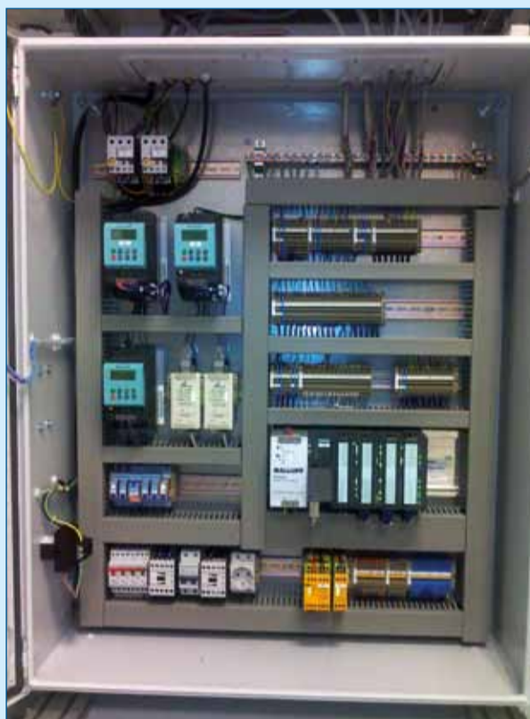
Figuur 4. De besturingskast van de KUA. Duidelijk zijn de gele veiligheidssysteem van Pilz te herkennen.
