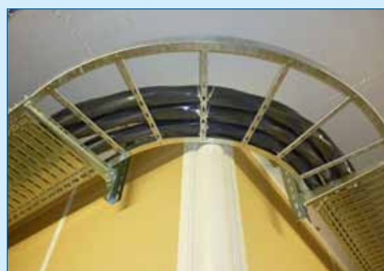
Figuur 3. De kabel mag gewoon in een kabelgoot.
