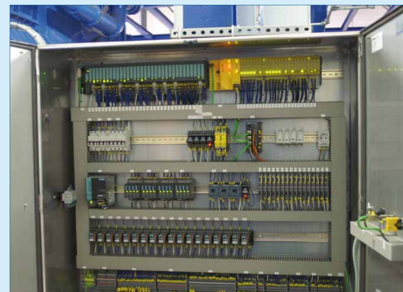
Figuur 3. Eén van de vele schakelkasten op de werkvloer.
