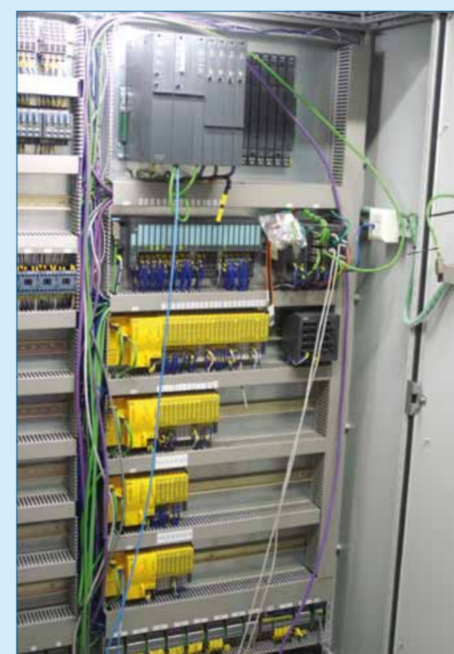
Figuur 2. De hoofdbesturing van de fabriek van ARN bestaat uit PLC's en het besturingsplatform PSS 4000 van Pilz voor de veiligheid.
