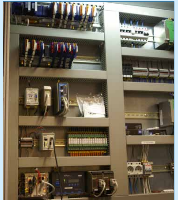
Figuur 3 →. De besturingskast op het Zoneiland Almere. Hier is de PCD3 van Saia Burgess te vinden.
