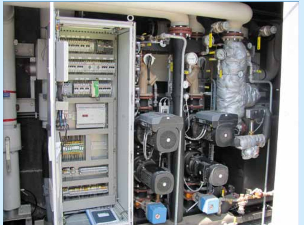
Figuur 1. In de wijken zijn meerdere onderstations geplaatst die de warmte uit het centrale net naar de woningen brengt. Een PLC zorgt er voor dat dit op een goede manier gebeurt.
