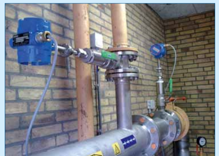
Figuur 2. De gasmeter in een biogasinstallatie. Ook hier is een hot tap toegepast
